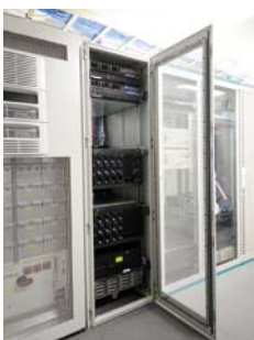
横浜市のテクノロジーセンター(GTAC)に構築されたメインサイト。8台のESXホスト上で150台の仮想サーバが稼働している。
